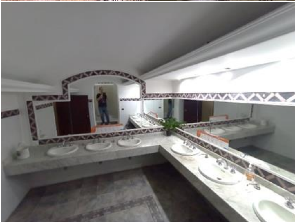
Fotos del estado actual de los baños del hall de las mujeres y lavamanos de los hombres.
