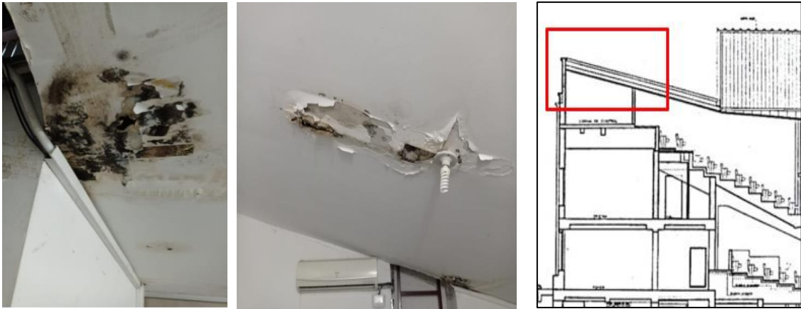
Fotos del estado actual de la zona del cielo raso de la emisora del Teatro Tolima. Se encuentra en el cuarto piso en el sector de la cubierta en una sola agua, ver cuadro rojo.
